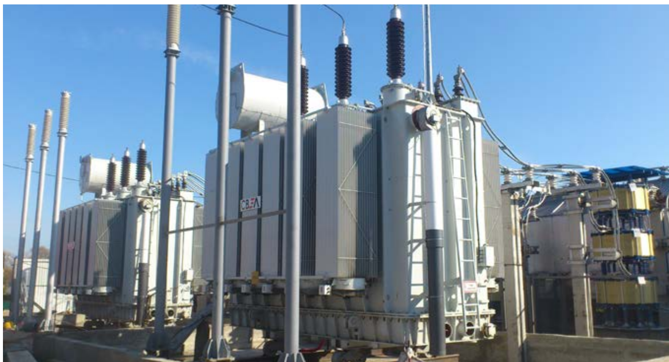
ПС «Привокзальная», г. Тула, ТДТН-40 000/110 У1
