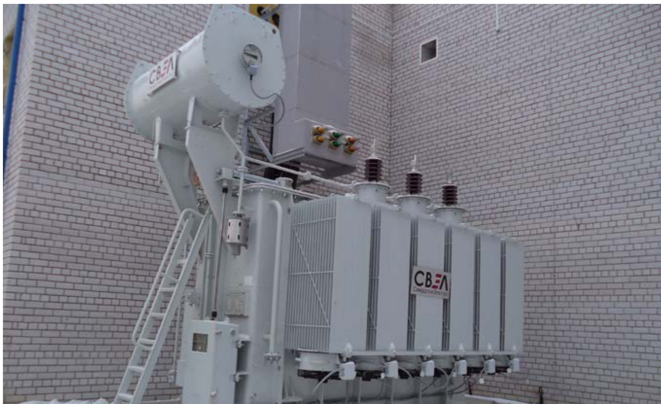
ПС «Западная», г. Вологда, ТРДНС-25 000/15 УХЛ1
