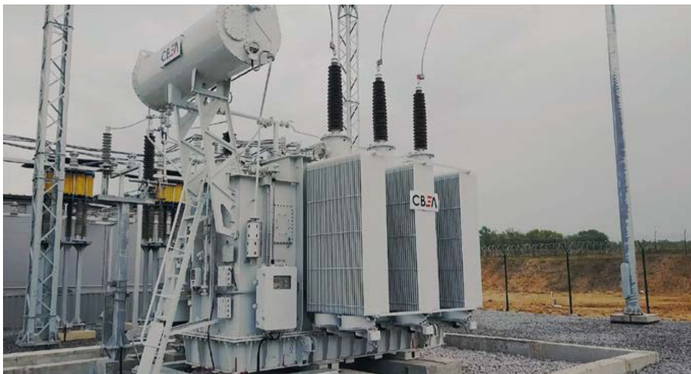
ПС «Гринхаус», Белгородская область, ТРДН-63 000/110 УХЛ1
